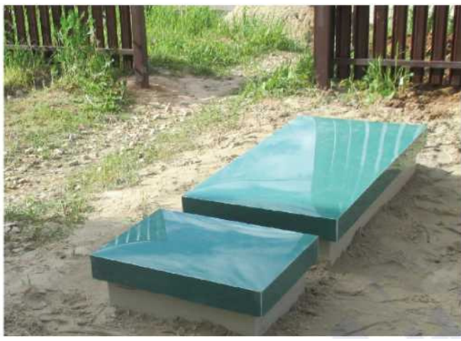
Размещение возле входа на участок для удобства сервисного обслуживания (удобный подъезд ассенизационной машины)
