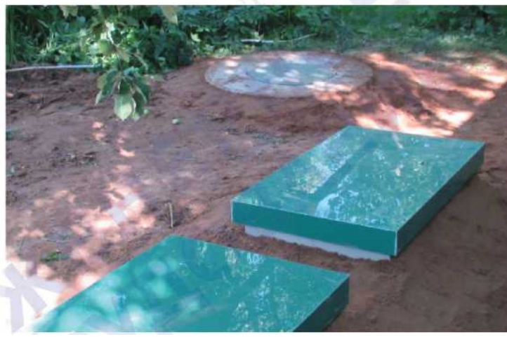
Сброс очищенной воды в поглощающий колодец
